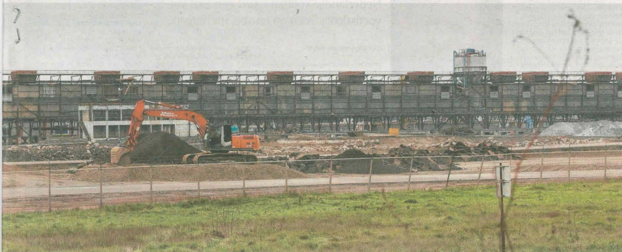
■ In opdracht van eigenaar UTB Industry sloopt Hoondert momenteel de voormalige smelterij van de eind 2011 failliet gegane aluminiumproducent Zalco NV. Naar verwachting zal UTB het geschoonde terrein medio volgend jaar overdragen aan Zeeland Seaports, die de 30 hectare havenindustriegrond opnieuw kan uitgeven. foto Johan van der Heijden
